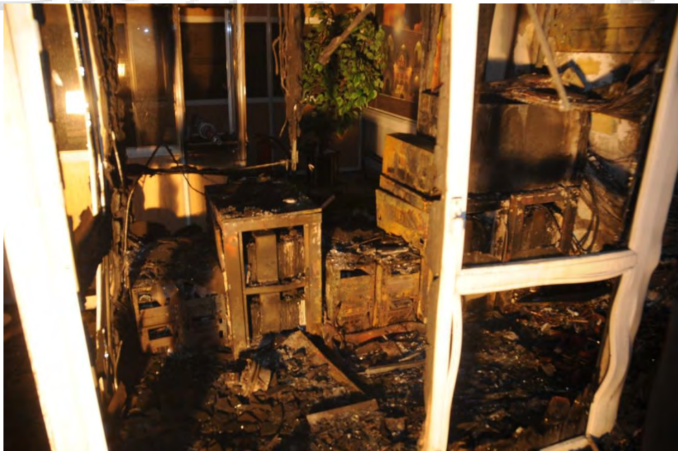
شکل ۲- عکس‌نگارش سوزی اتاق ups و سرور قیپ همراه گزارش‌نگارش‌شده
